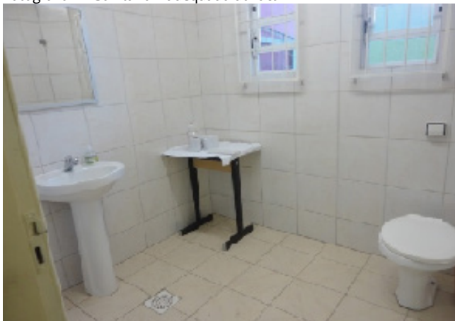
Fotografia 6 – Sanitário inadequado do local B
